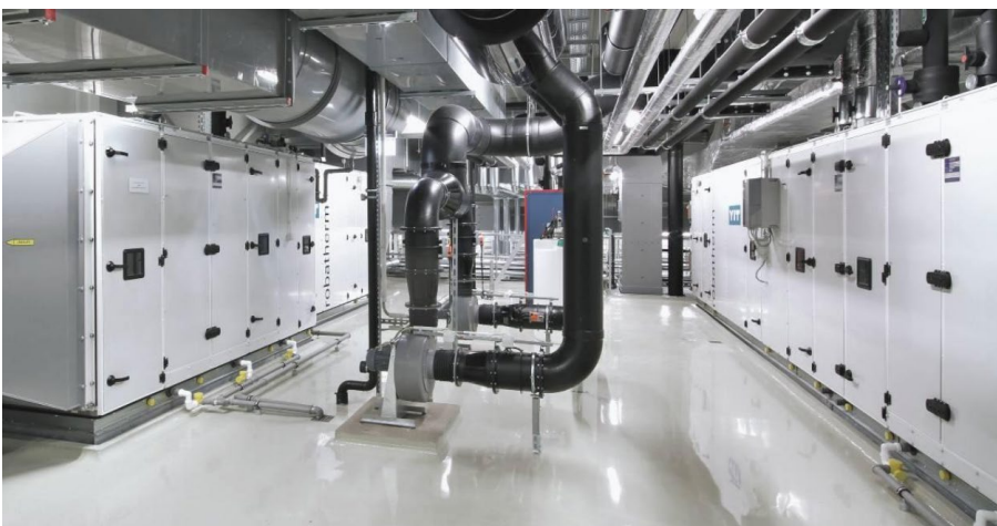
Bild 4: Lüftungsanlagen im Plenum oberhalb des Arbeitsbereichs (Quelle: robathern)
